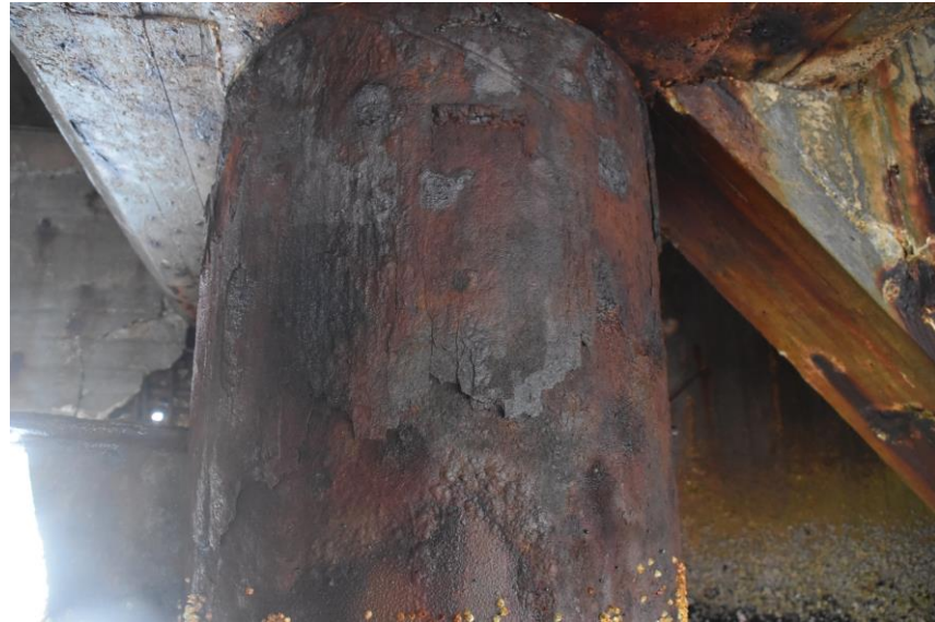
Korrosjon i stålrørspel
